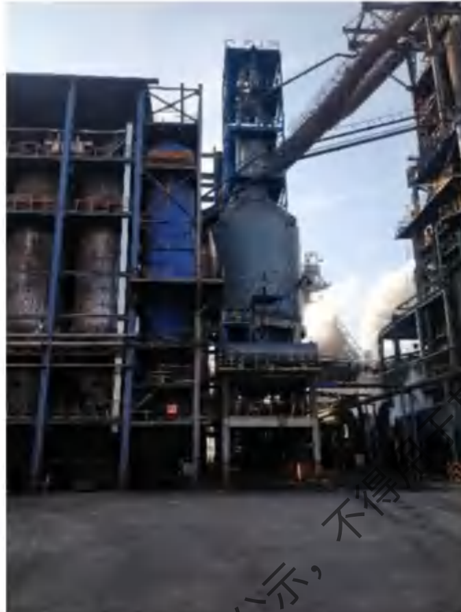
均压放散除尘灰灰仓
