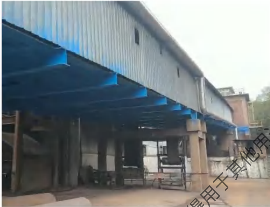
烧结原料上料皮带通廊
