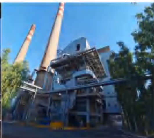
5#烧结机机头脱硫脱硝
