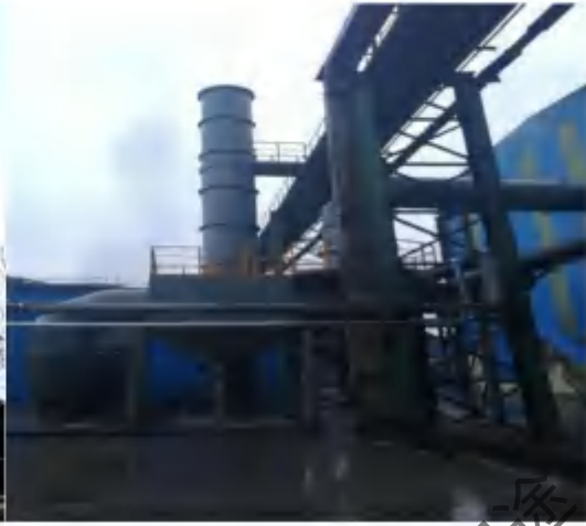
钢渣湿式除尘
