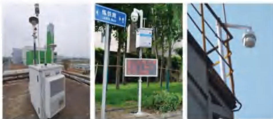
图 3.1-4 厂区监测监控
